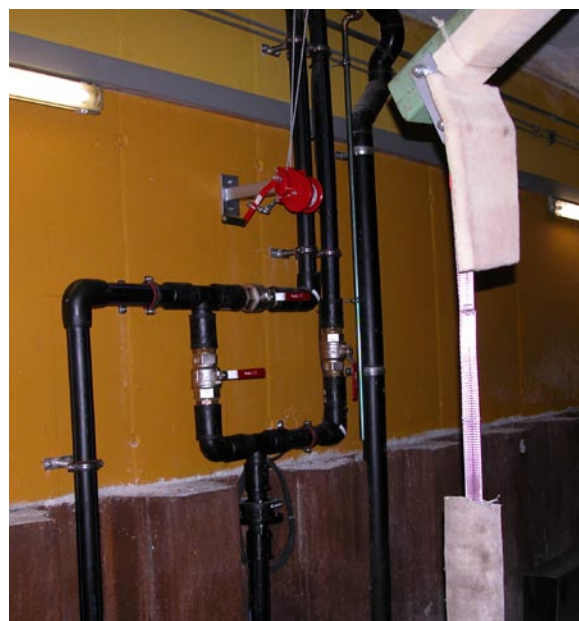
Mit diesen Leitungen werden dem See das Wasser entnommen. Sie sind in der Bootshalle oberirdisch angelegt.
